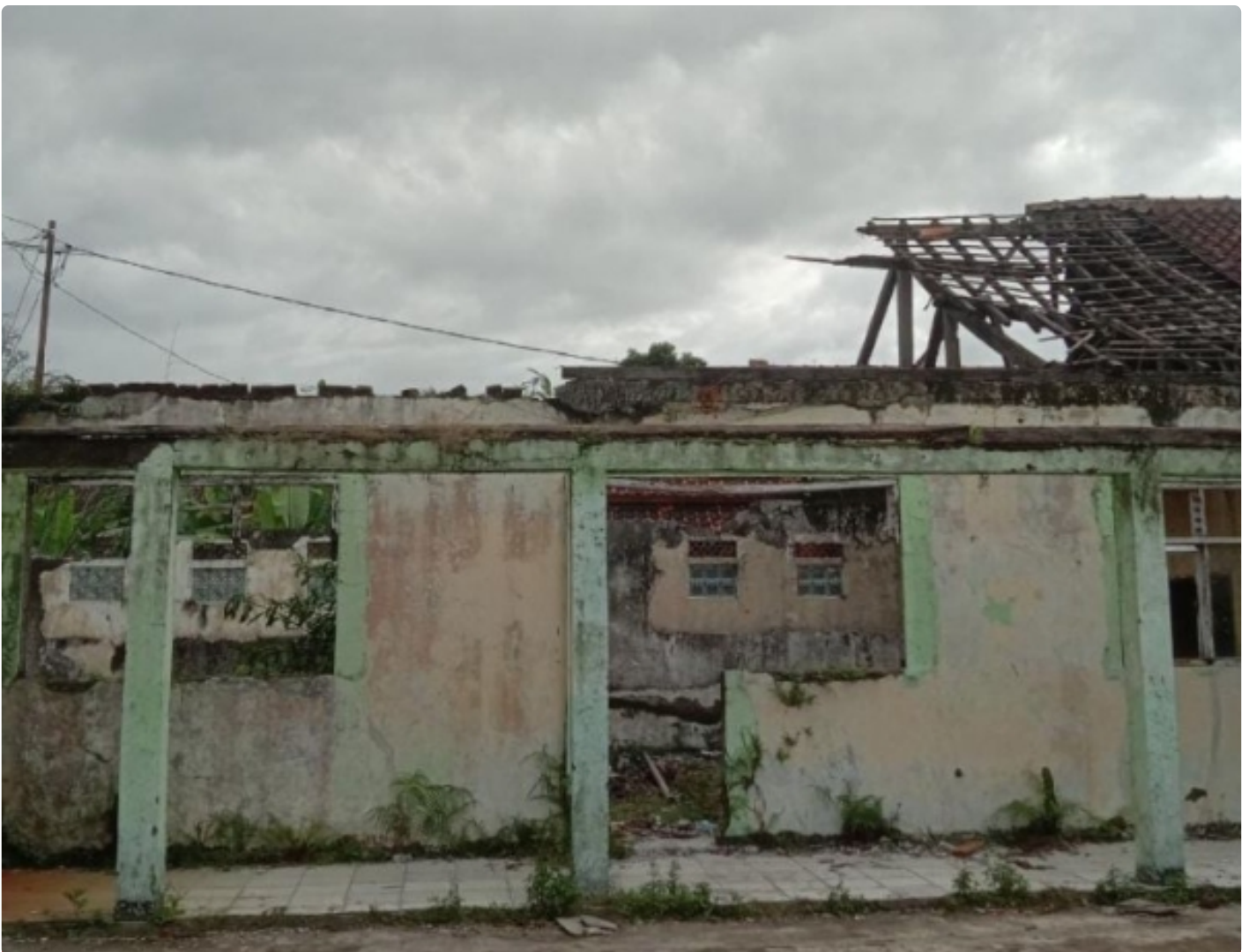
Bangunan Sekolahnya Rusak Parah, Ini Kata Kepsek Mts Albairuni
